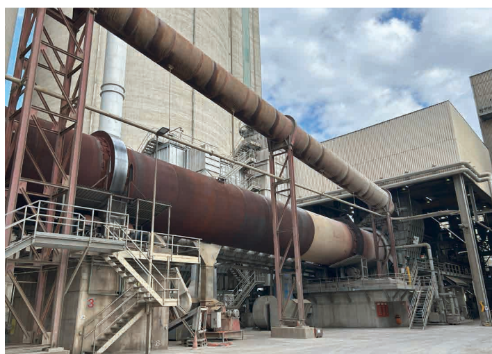
Four de la cimenterie
