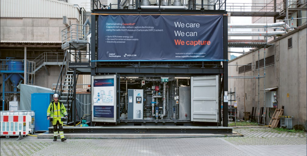
Installation de démonstration de captage du CO 2 de Capsol
