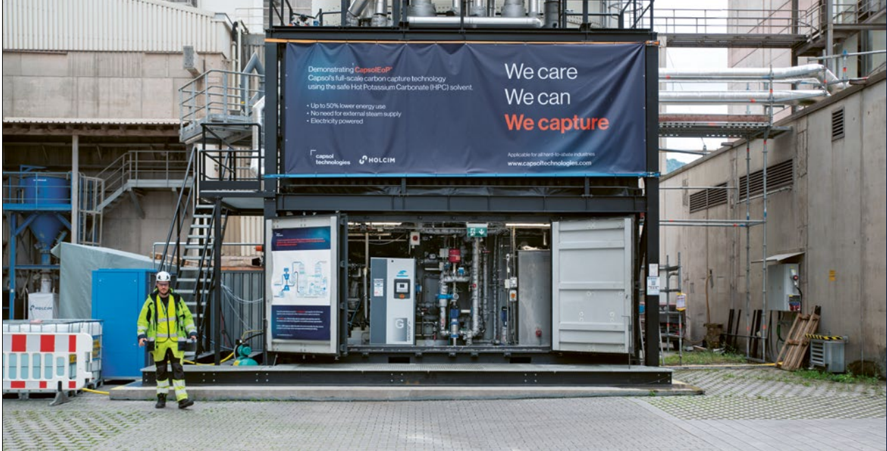
Demonstrationsanlage zur CO 2 -Abscheidung der Firma Capsol
