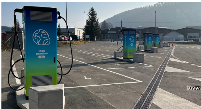
Foto: Die Ladestationen beim Zementwerk Siggenthal
