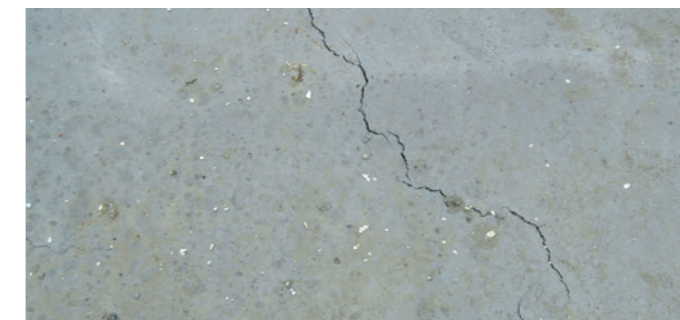
Fissures typiques de la dalle en béton dues au retrait plastique en raison d'une dessiccation précoce.
