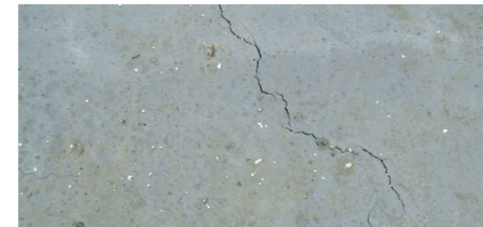
Typische Fröhschwindrisse infolge vorzeitiger Austrocknung einer Betondecke.
