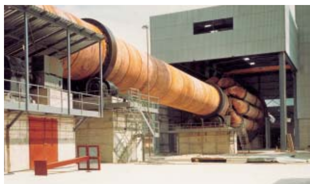
Le four F.L. Smidth, installé en 1974, est toujours en service aujourd'hui
