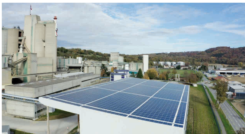
Panneaux solaires photovoltaïques
