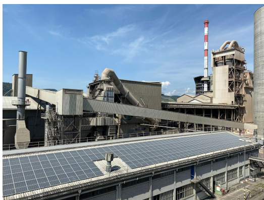
Die neue Photovoltaik-Anlage erzeugt Solarstrom für das Werk.
