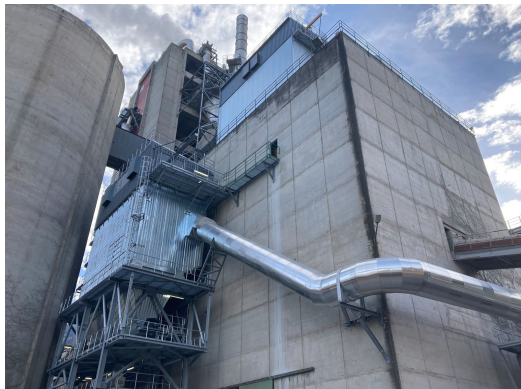
Der neue Bypass erhöht die Kapazität für alternative Brennstoffe.
